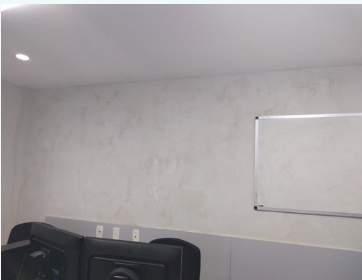
Figura 4: Parede com mofo
