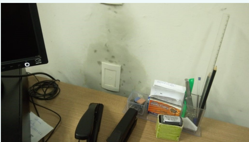
Figura 5: Parede com infiltração
