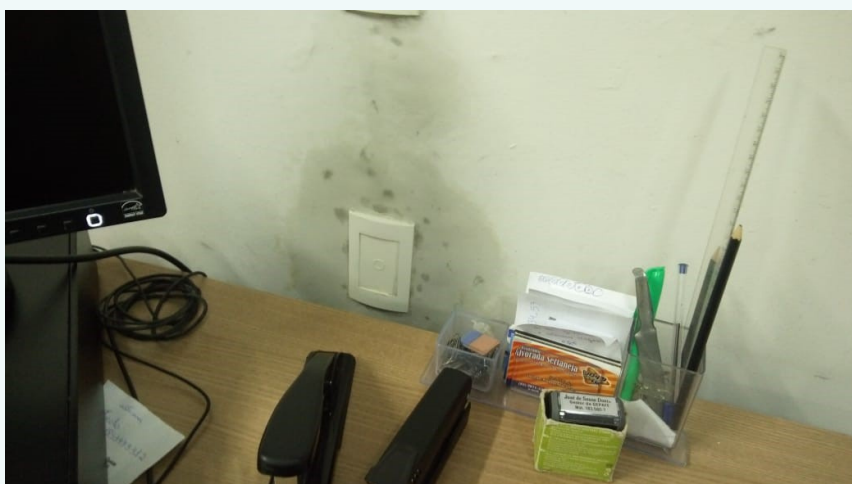
Figura 5: Parede com infiltração
