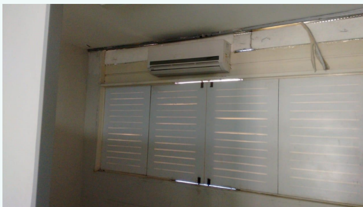
Figura 3: Adaptações - Instalações de Ar Condicionado
