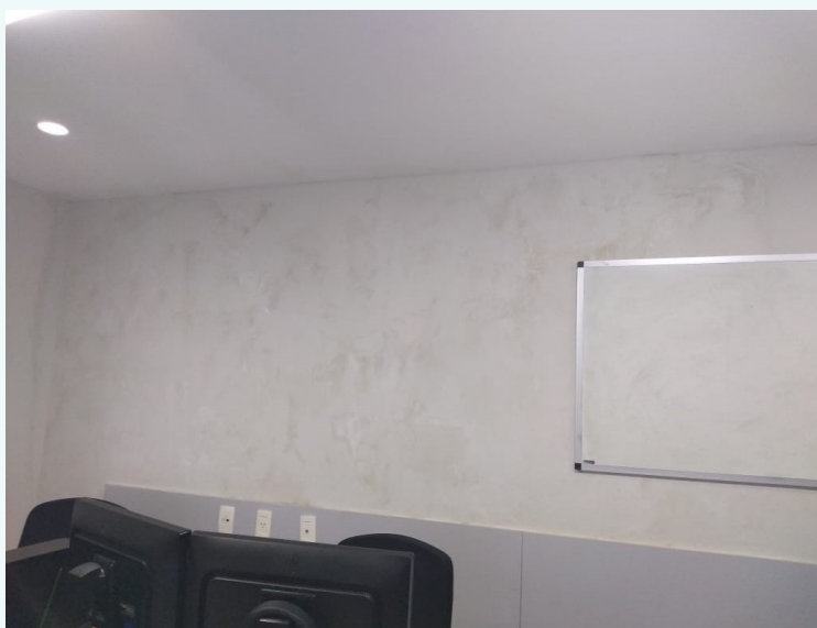
Figura 4: Parede com mofo
